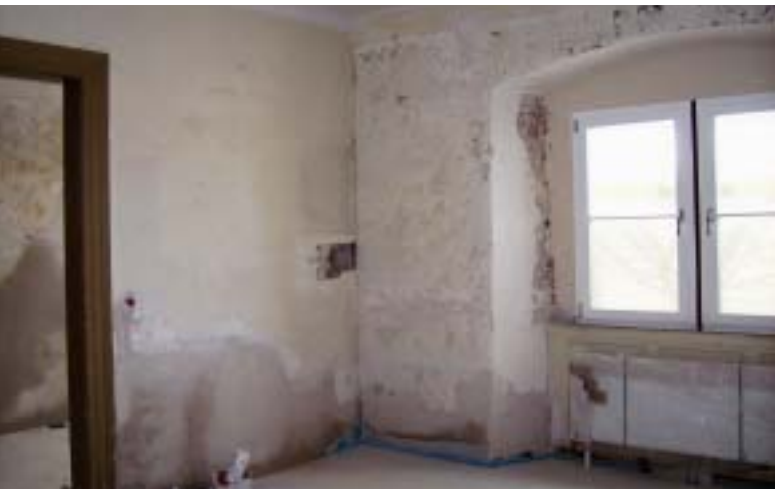
Die Innenwände im Waldseer Hof wiesen teils starke Feuchtigkeitsschäden auf.
